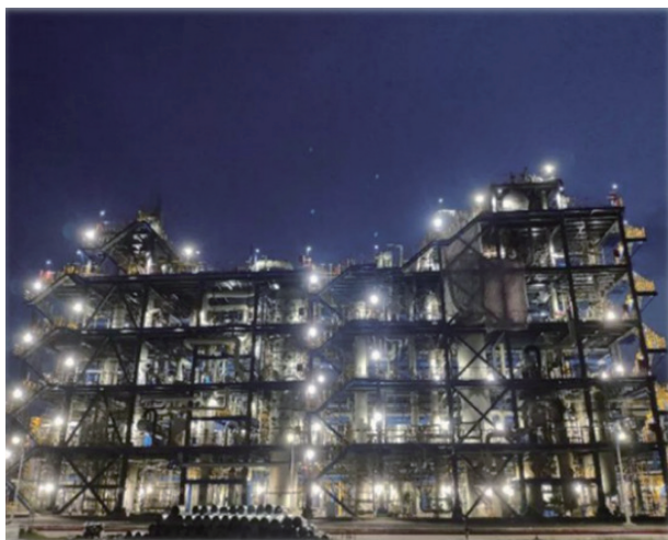
图 4 年产 5 万吨乙烯多相氢甲酰化及加氢制正丙醇工业装置
